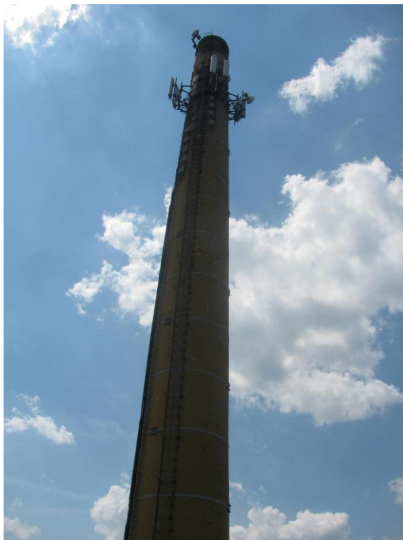
Zał. nr 1: Widok ogólny instalacji radiokomunikacyjnej.
